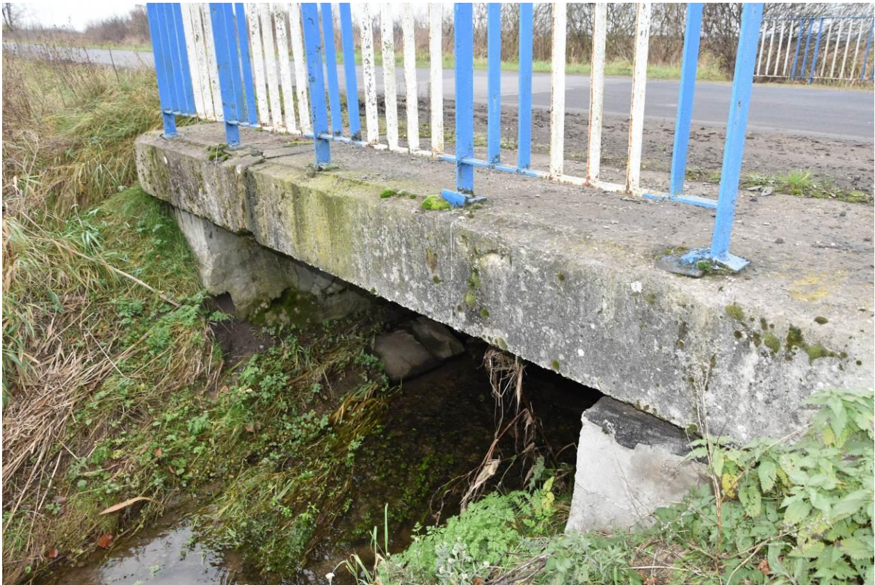
Fot. 5. Widok z boku. Korozja i wykwyty na betonie gzymsu. Ubytek gruntu pod podporą. Ubytek betonu podpory.
