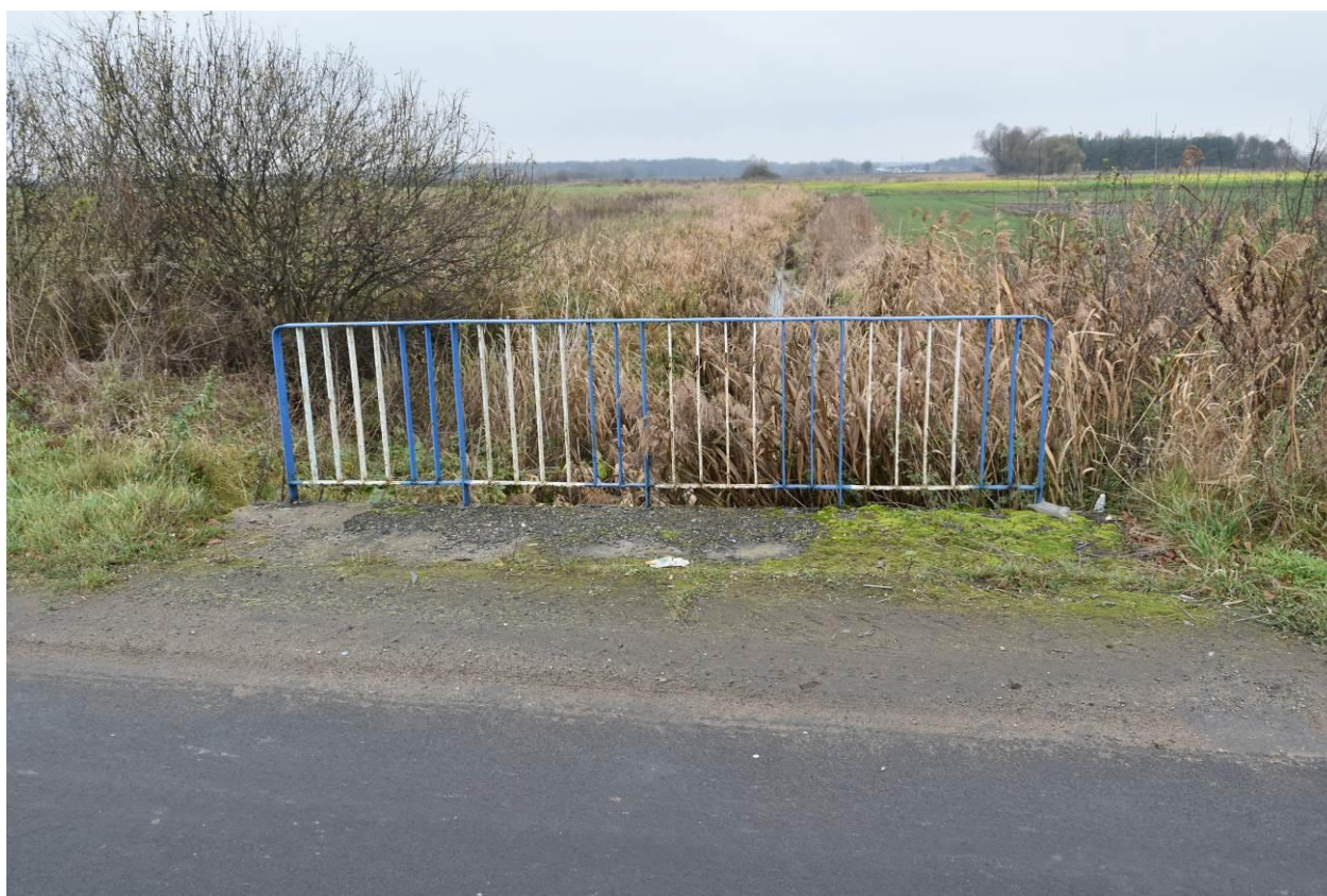
Fot. 4. Wykwity i wegetacja roślin na powierzchni betonowej kapy.
