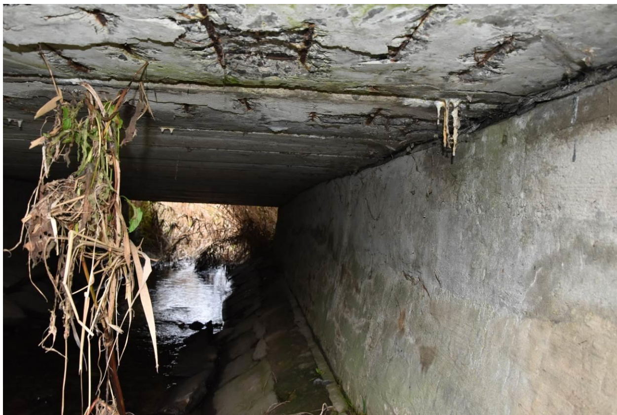
Fot. 9. Przecieki, osady i wykwyty na dźwigarze. Korozja stali zbrojeniowej i ubytki betonu.
