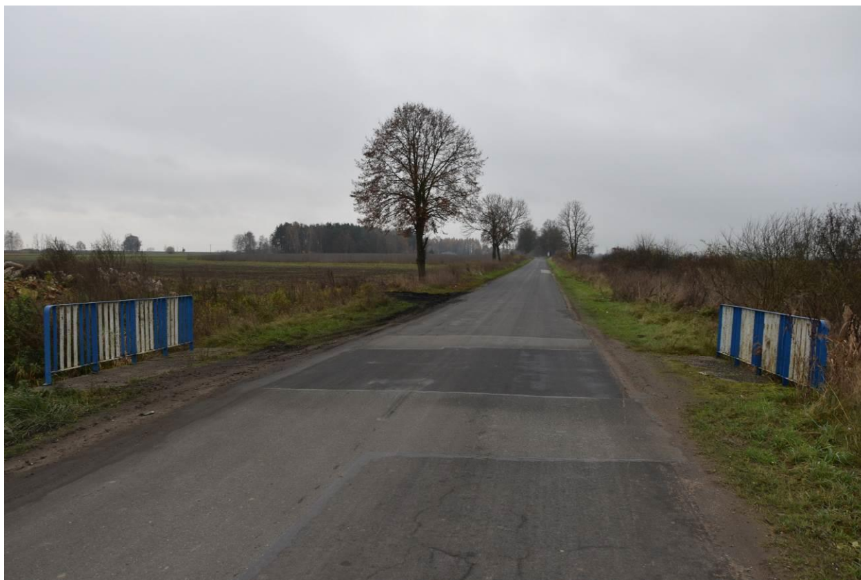
Fot. 1. Widok na dojazdy i obiekt. Spękania nawierzchni na dojazdach.
