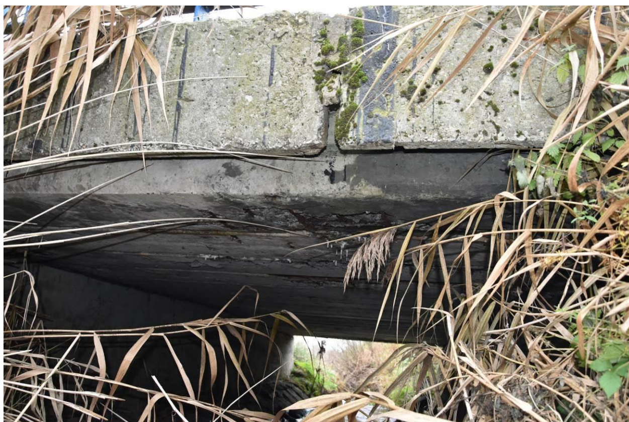
Fot. 10. Widok z boku. Wykwity na gzymsie. Przecieki, osady i wykwyty na dźwigarze. Korozja stali zbrojeniowej i ubytki betonu.
