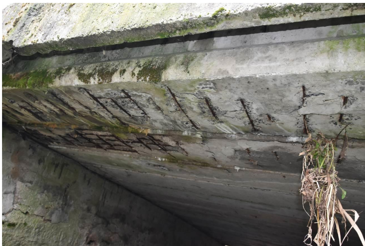
Fot. 8. Przecieki, osady i wykwity na dźwigarze. Korozja stali zbrojeniowej i ubytki betonu.
