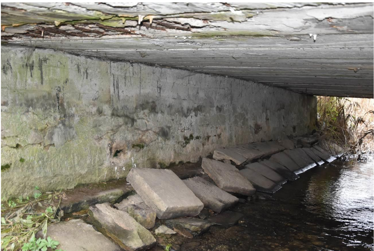
Fot. 6. Widok na podporę i dźwigar. Degradacja betonu na dźwigarze i podporze. Znaczne ubytki betonu na dźwigarze.
