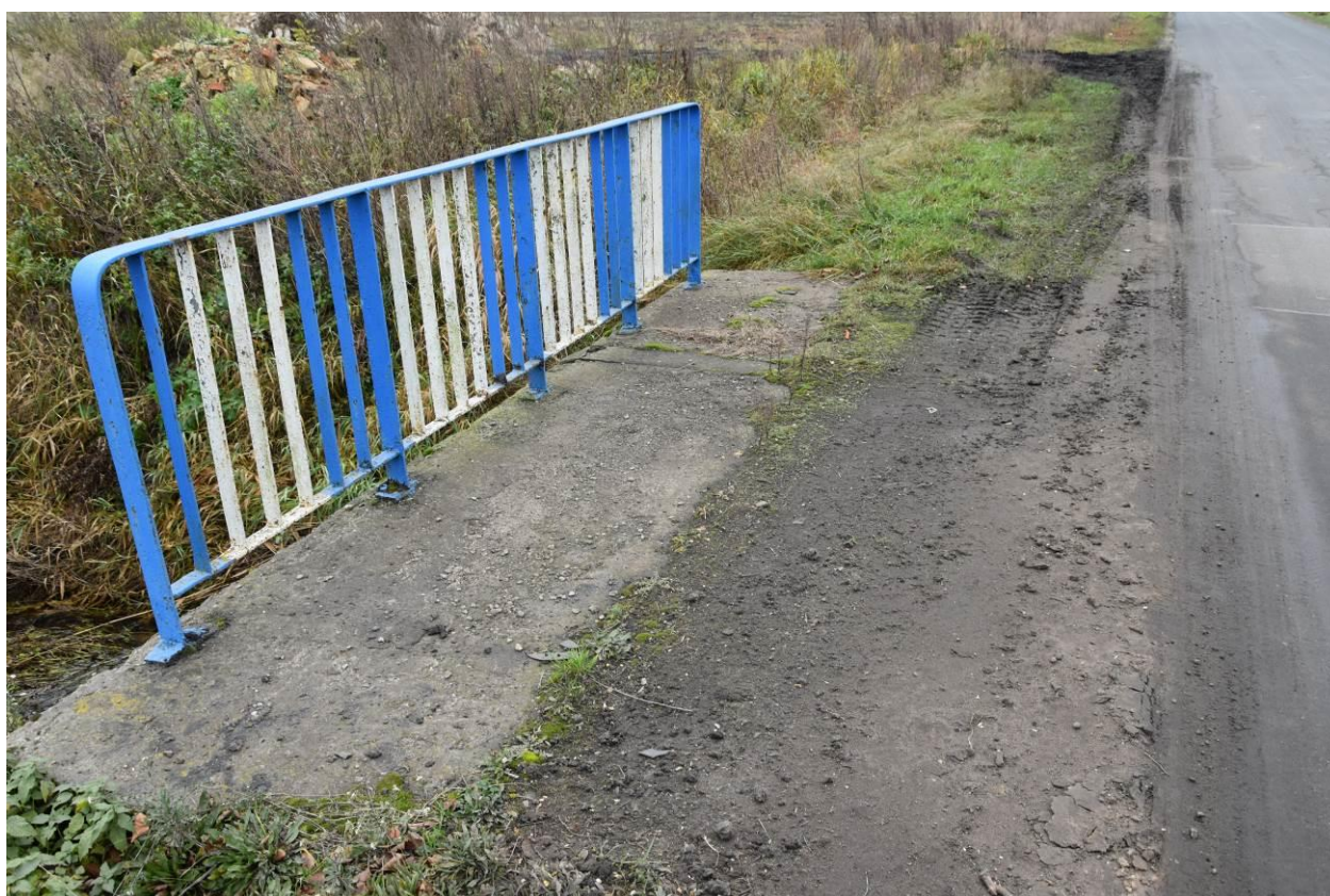
Fot. 2. Widok na przejście i balustradę na obiekcie. Korozja betonu na kapie. Korozja stali balustrady.
