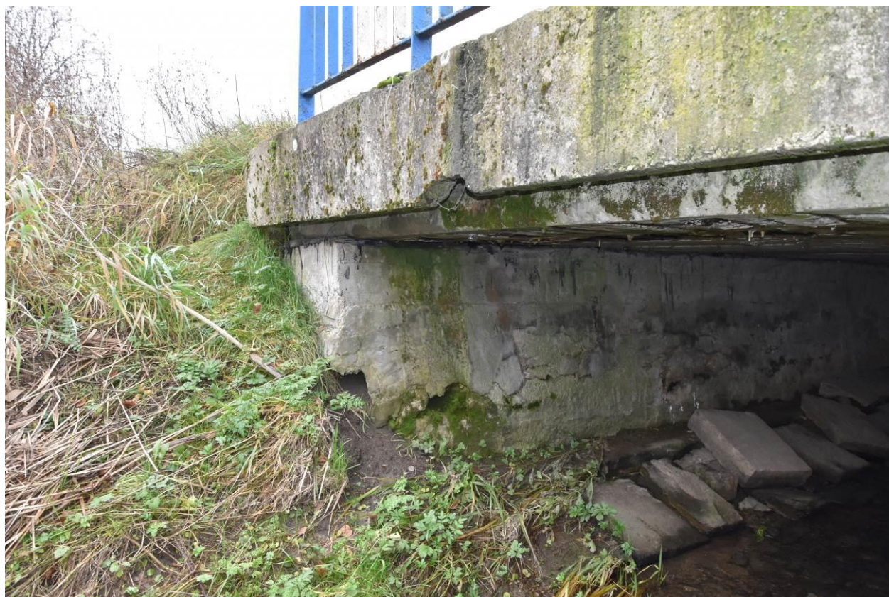
Fot. 7. Degradacja betonu podpory. Przemieszczenie elementów umocnienia koryta.
